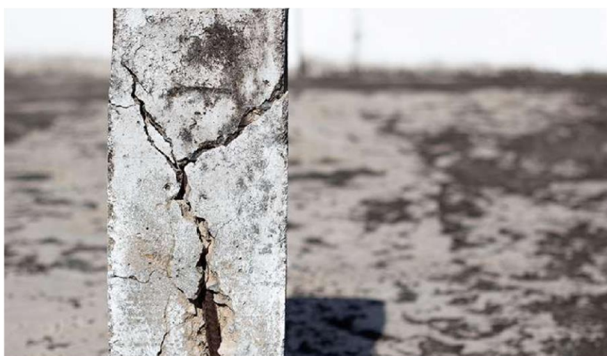
Figura 3: Corrosão de Armadura de aço no concreto
