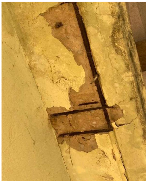
Figura 5: Corrosão de Armadura de aço e falta de cobrimento
