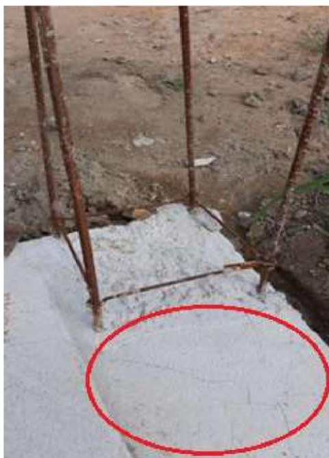
Figura 4: Oxidação de Armadura de aço e Fissura na Estrutura Fonte: Próprio (2022)
