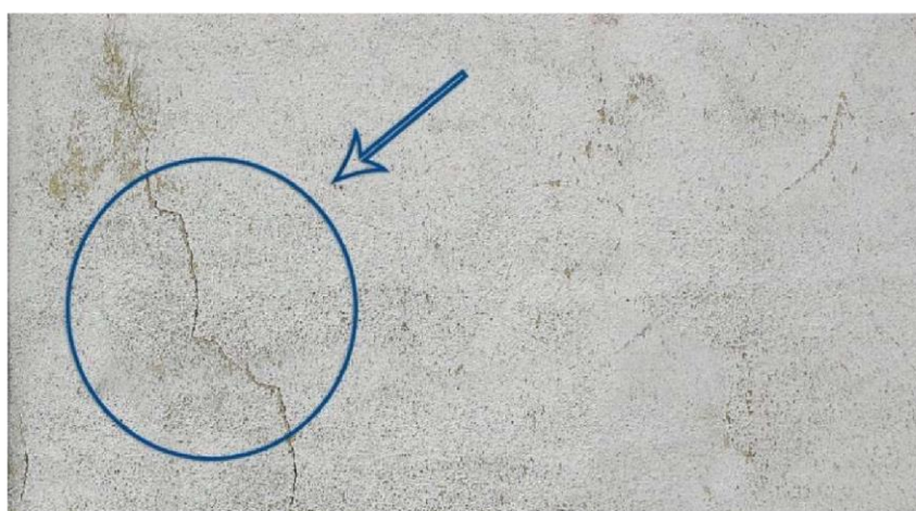
Figura 2: Fissuras no concreto
