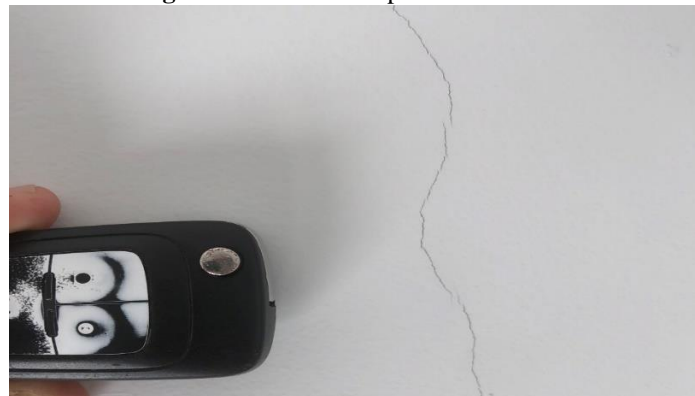
Figura 13: Fissura em parede – Casa 1
