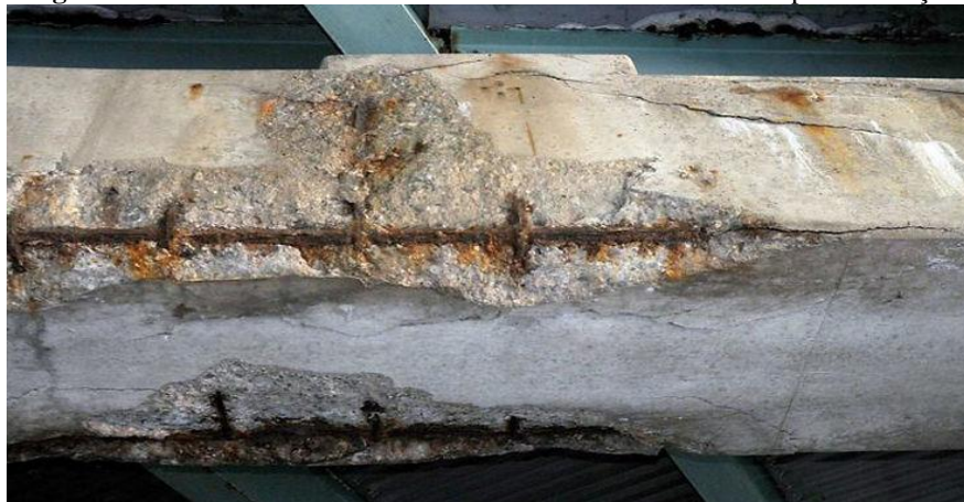
Figura 4: Estrutura em concreto armado com armaduras afetada por infiltração
