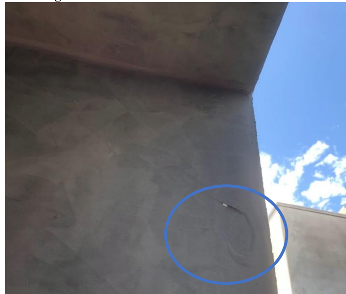
Figura 14: Abaulamento de massa corrida – Casa 2
