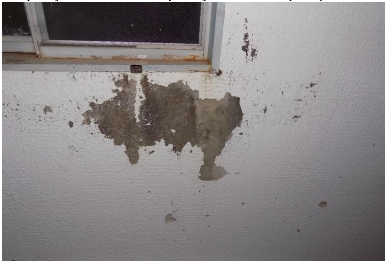
Figura 5: Descascamento da pintura externa; Fonte: Acervo próprio, 2019
