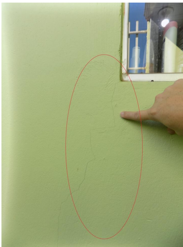
Figura 3: Fissura de 45° a partir do vão de janela; Fonte: Acervo próprio, 2019
