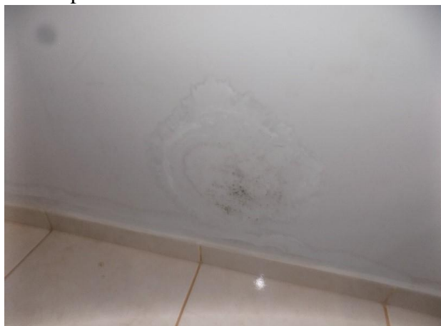
Figura 8: Manchas provocadas por umidade em estágio avançado; Fonte: Acervo próprio, 2019
