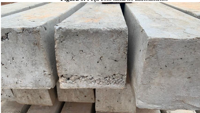
Figura 6: Peça com falha no adensamento
