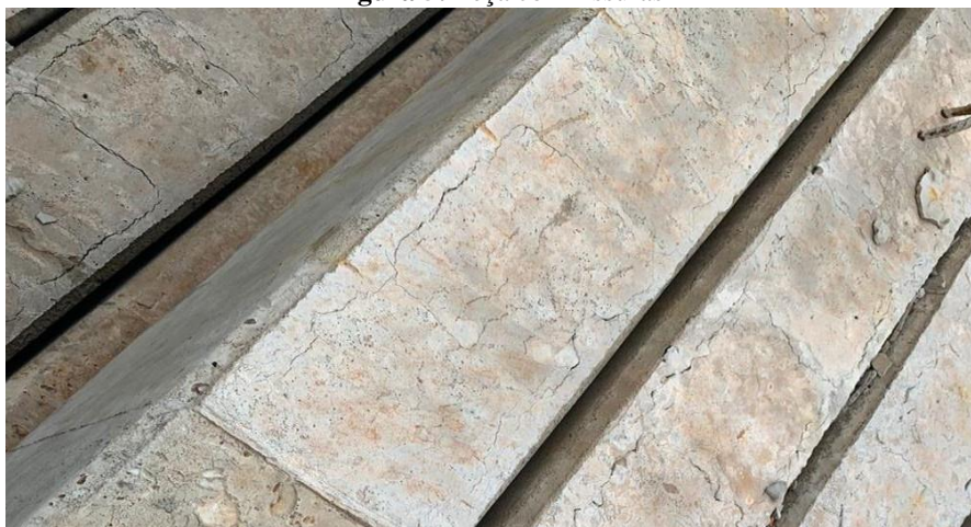
Figura 5: Peça com fissuras
