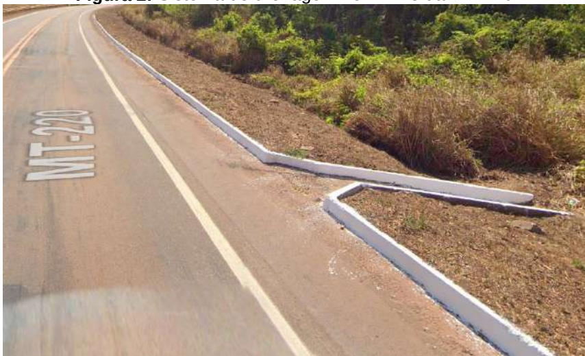
Figura 2: Sistema de drenagem no KM 13 da MT-220.
