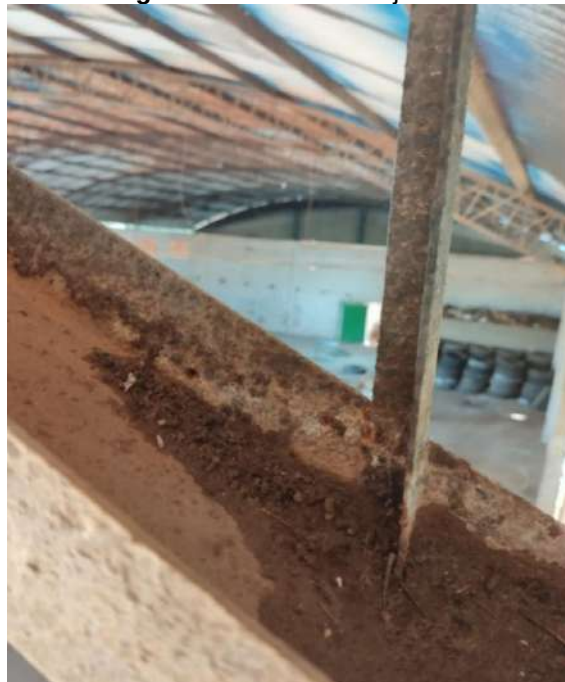
Figura 9: Corrosão em juntas.
