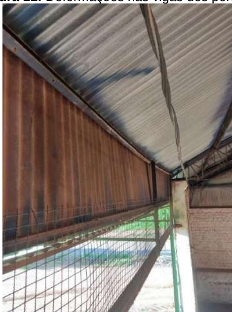
Figura 11: Deformações nas vigas dos portões.
