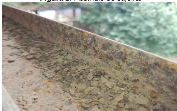
Figura 2: Acúmulo de sujeira.
