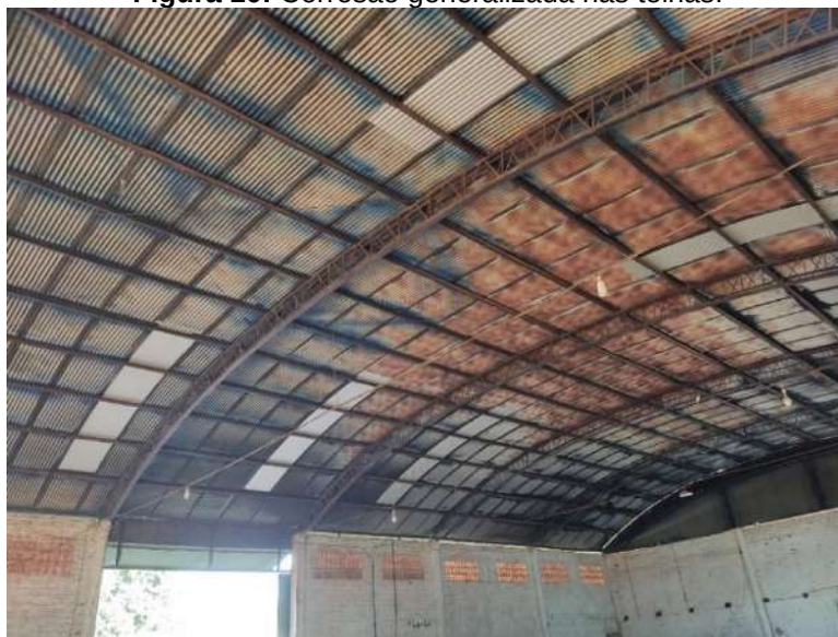
Figura 10: Corrosão generalizada nas telhas.
