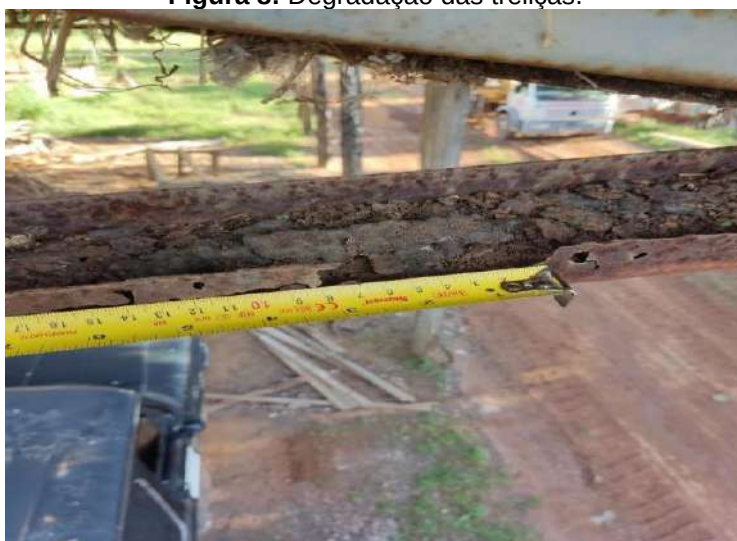
Figura 8: Degradação das treliças.
