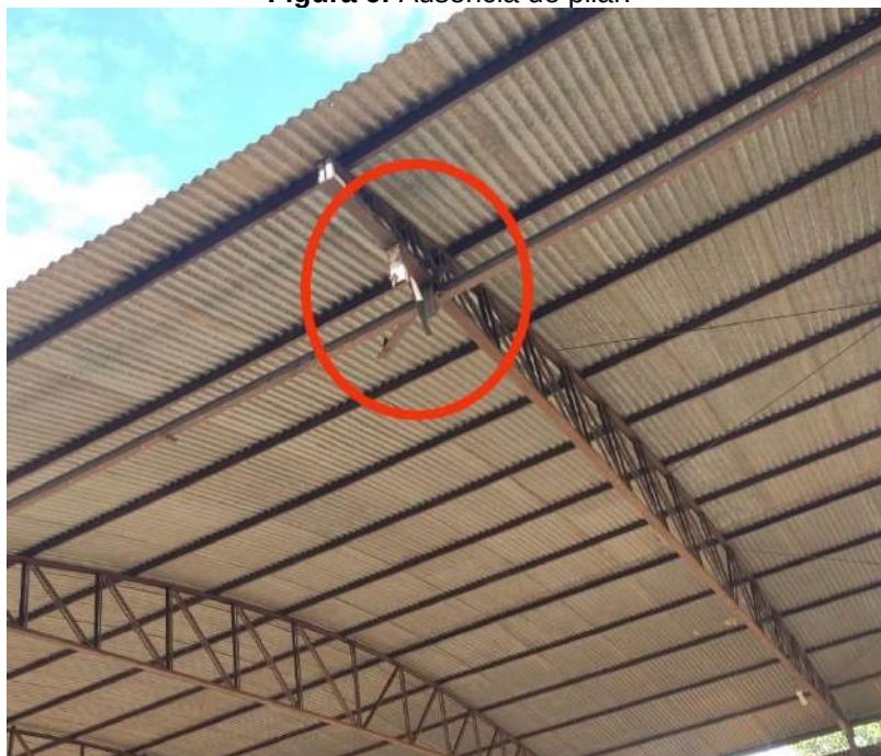
Figura 6: Ausência de pilar.
