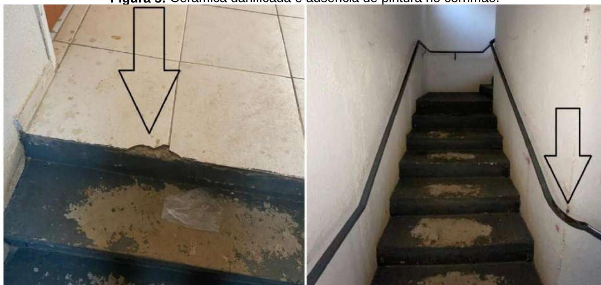
Figura 5: Cerâmica danificada e ausência de pintura no corrimão.
