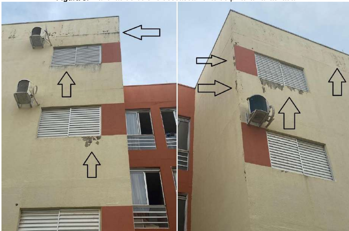
Figura 8: Manchas de bolor e descascamento de pintura na fachada.
