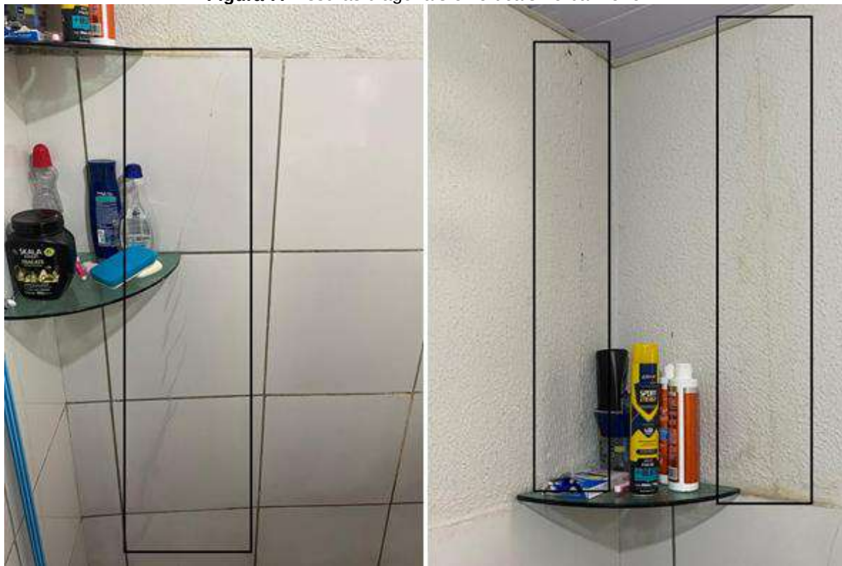
Figura 7: Fissuras diagonais e verticais no banheiro.
