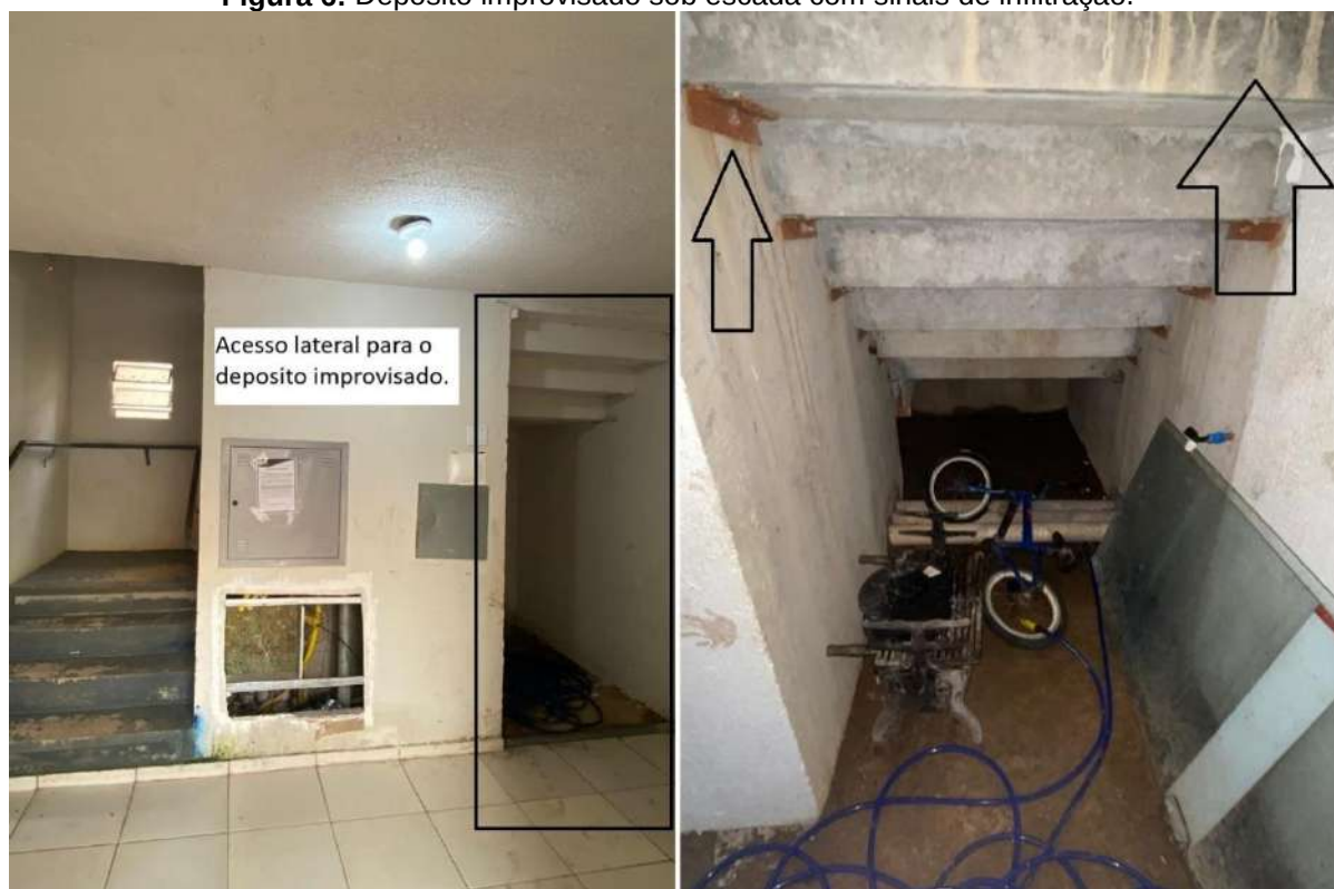
Figura 6: Depósito improvisado sob escada com sinais de infiltração.
