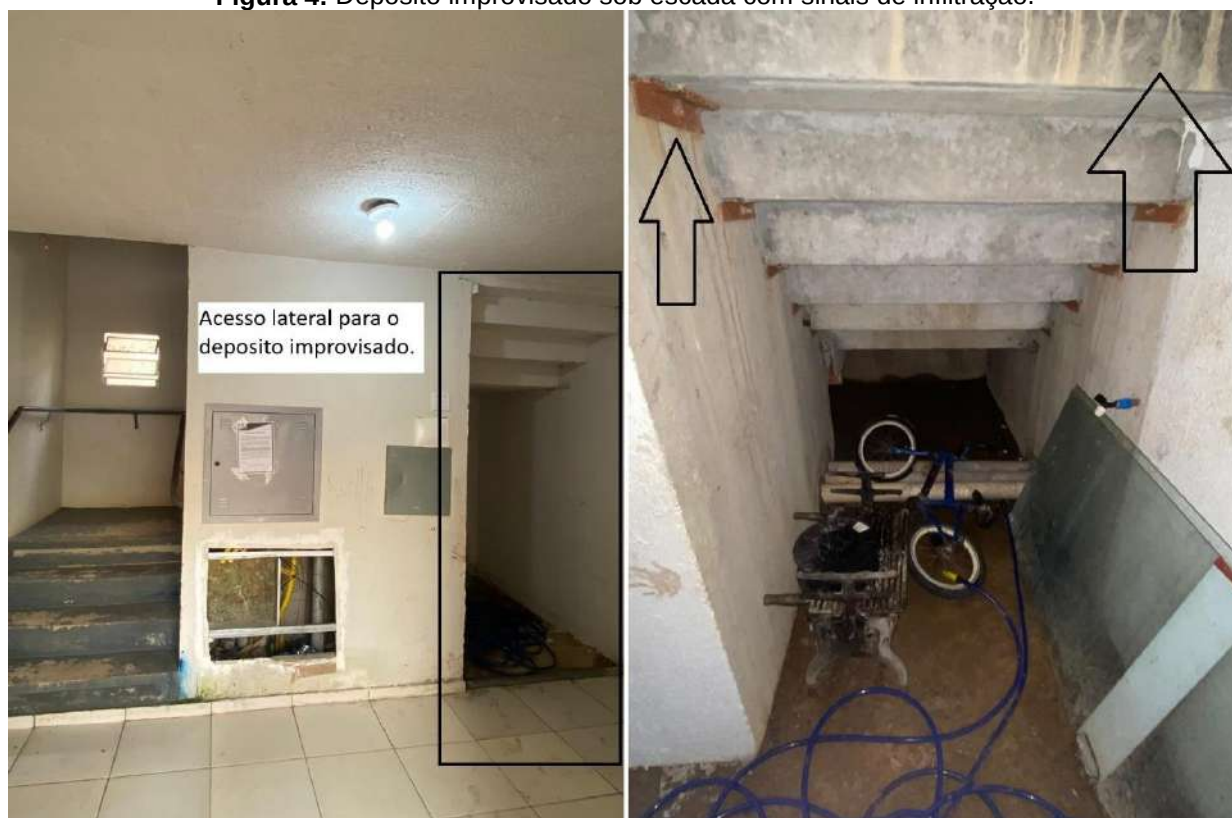
Figura 4: Depósito improvisado sob escada com sinais de infiltração.
