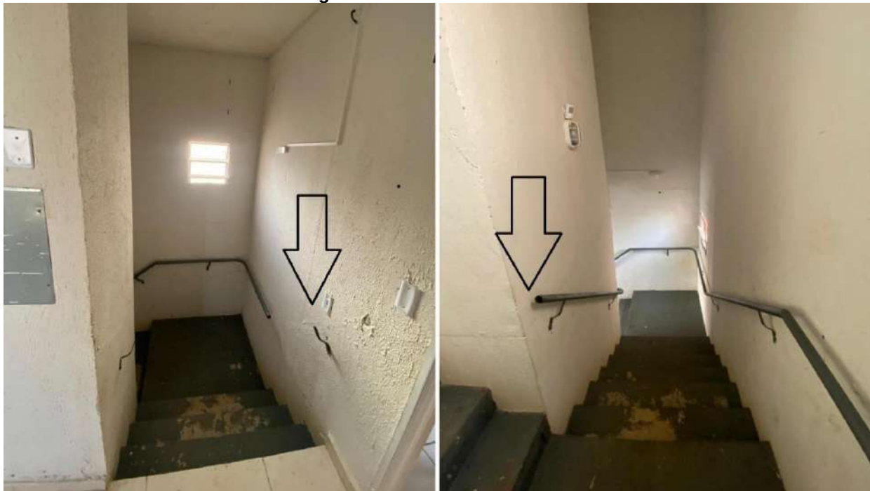
Figura 3: Ausência de corrimão.
