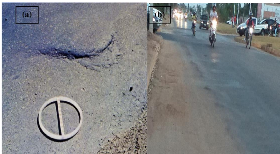
Figura 3: (a) modelo de ocorrência segundo DAER – RS (1978), (b) manifestação patológica caracterizada como escorregamento encontrada na avenida André A. Maggi
