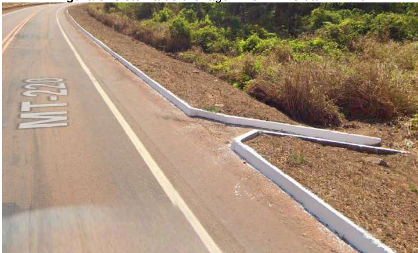
Figura 3: Sistema de drenagem no KM 13 da MT-220.
