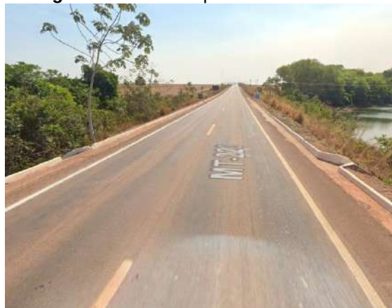
Figura 6: Drenos superficiais do KM 22.
